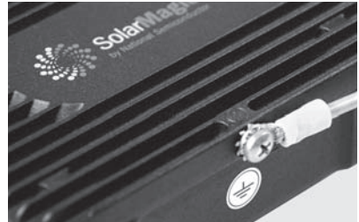
図7. UL指定リング・クリンプ端子とUSE-2/RHW-2継り接地線
