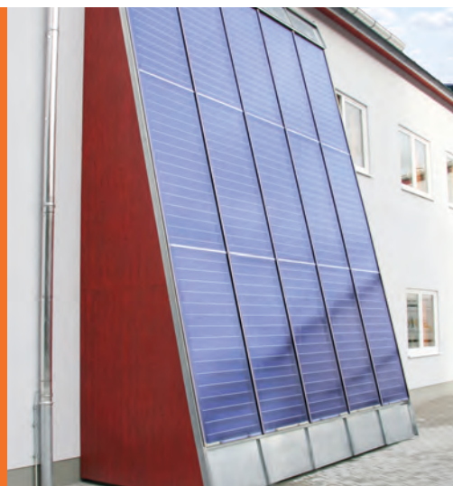
Maßgeschneiderter Fassadenkollektor am soleg Firmengebäude in Teisnach (30 m 2 Kollektorfläche)
